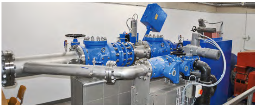
Die Armaturen, Kugelhähne PN 40, im neu gebauten Kraftwerksgebäude.
